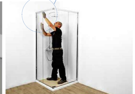
4 AGGANCIAMENTO VETRI FISSI I vetri di struttura vengono fissati tramite sistemi ad incastro e guarnizioni
